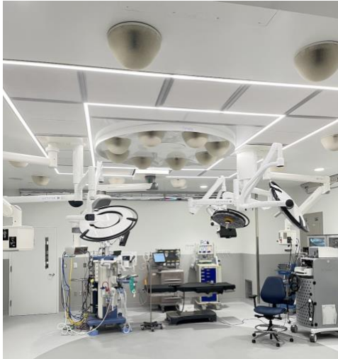
Abbildung 1: Ein installiertes Opragon-Lüftungssystem in einem OP-Raum. Das Einbringen der HEPA-gefilterten Zuluft erfolgt über die halbkugelförmigen Auslässe (sog. Luftduschen) über der OP-Zone und in den anderen Bereichen des OP-Raums. (alle Abb. © Avidicare)
